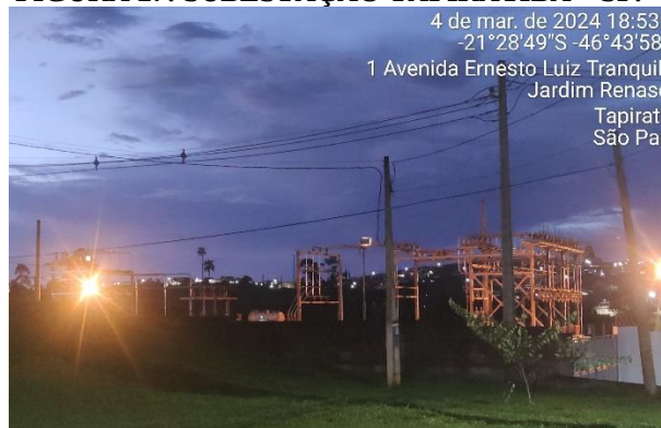
FIGURA 27: SUBESTAÇÃO TAPIRATIBA – SP.
